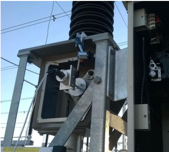
安装于 ABB LTB 245 kV SF6 断路器上的数字旋转传感器
